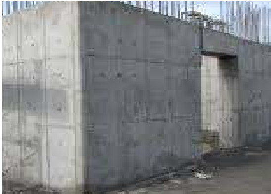
شکل ۱- سطح صاف و صیقل دیوار برشی
