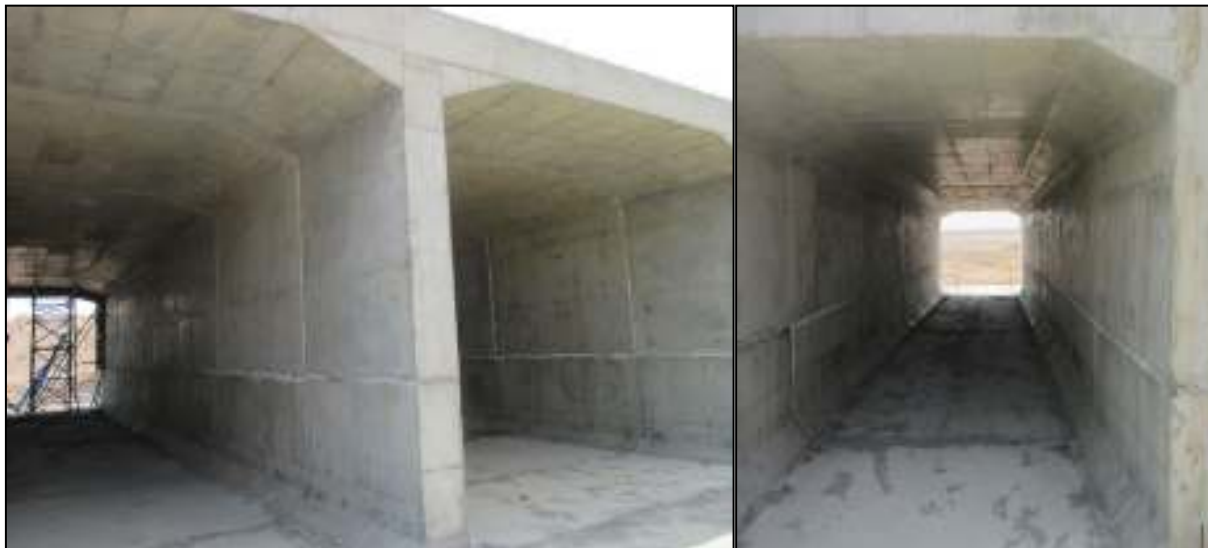
شکل ۹- نمایی از آبروهای اجرا شده در پروژه راه آهن سریع السیر تهران- قم- اصفهان پس از اصلاح طرح مخلوط بتن و رعایت اصول صحیح ویبره زنی و آموزش بیمانکاران
