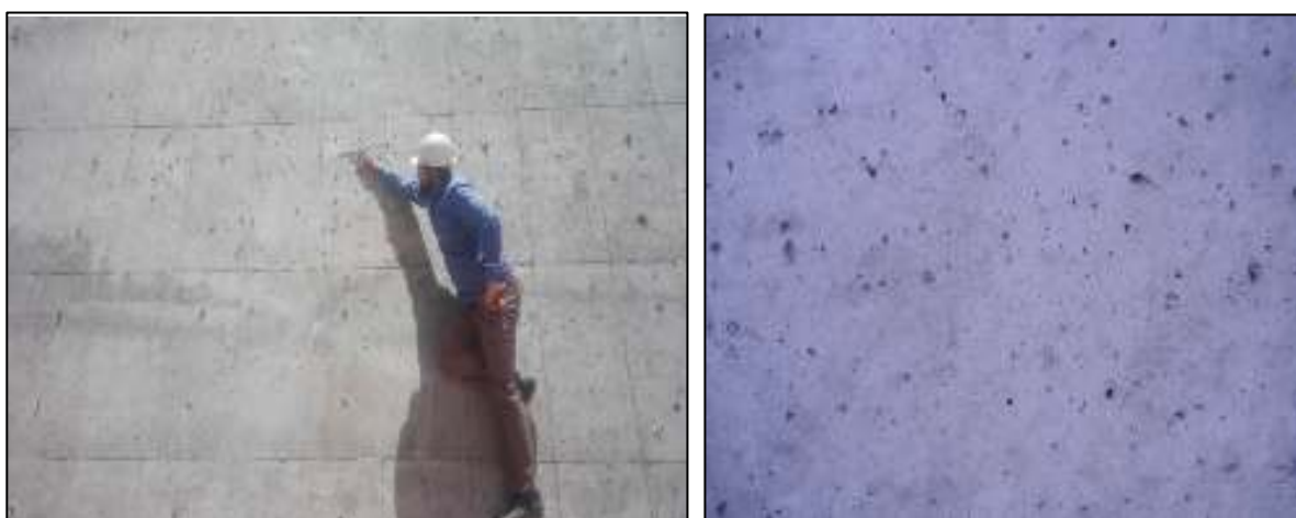
شکل ۴- تصاویری از وجود حباب در سطح بتن اجرا شده (سطح آبله رو)، در هر دو تصویر حباب‌ها دارای اشکال نامنظم هندسی هستند
