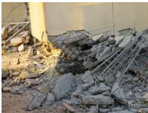
شکل (۱۱)- تخریب دیوار برشی در یک ساختمان مسکن مهر شهید شيرودی سرپل ذهاب
