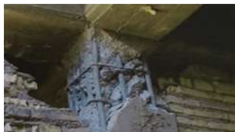
شکل (۷) - فواصل زیاد خاموت ها در ناحیه بحرانی ستون
