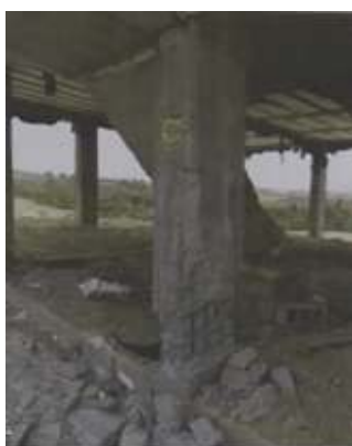
شکل (۸) - فاصله زیاد تنگ ها همراه با ضعف مقاومت بتن
