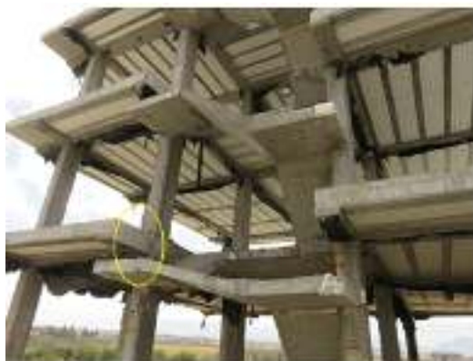
شکل (۲۴) - ایجاد ترک در تیر طره به علت نیروی قائم زلزله
