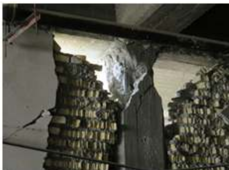
شکل (۱۶) - اثرات تخریبی متقابل دیوار و ستون
