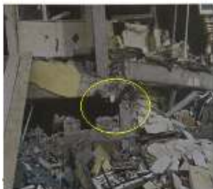
شکل (۲) - خرابی کلی در اثر ستون کوتاه
