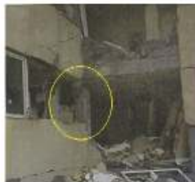
شکل (۱) - ایجاد ستون کوتاه به دلیل دیوار کوتاه میانقاب
