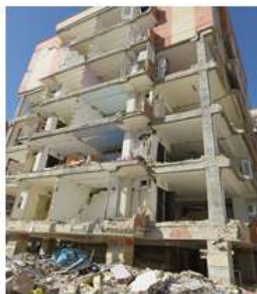
شکل (۱۵) - تخریب دیوارها در ساختمان مسکن مهر شهید شیرودی سرپل ذهاب
