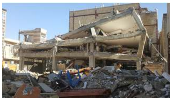
شکل (۹) - خرابی ساختمانی در سرپل ذهاب در اثر ترکیبی از ضعف های فنی از جمله طبقه نرم، طبقه ضعیف و ستون ضعیف - تیر قوی
