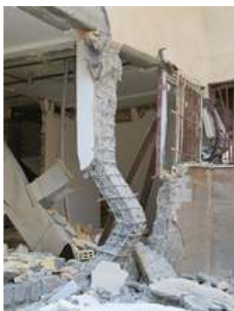
شکل (۶)-ضعف مقاومت ستون در طبقه همکف مسکن مهر در اسلام آبادغرب
