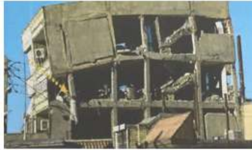
شکل (۲۰) - اثر تخریبی راه پله، پیچش، عدم اجرای وال پست، ستون ضعیف در سرپل ذهاب
