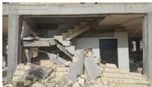
شکل (۱۸) - اثرات تخریبی متقابل دیوار و ستون
