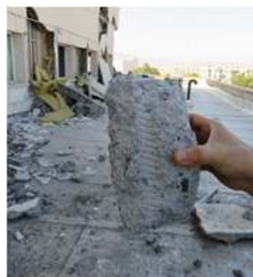
شکل (۲۵) - عدم وجود درشت دانه در یک تکه جدا شده از بتن
