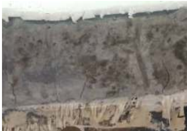
شکل ۸- ایجاد ترک خمشی در دال بتنی تقویت شده با ۲ لایه ورق GFRP
