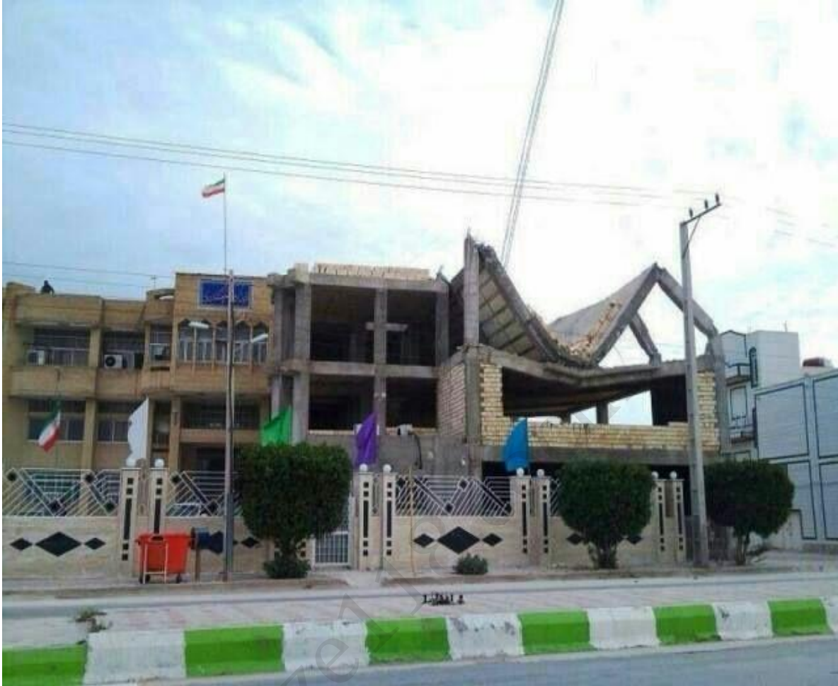
18 اتصال کابلی دال پله روشی کاملاً اشتباه .
