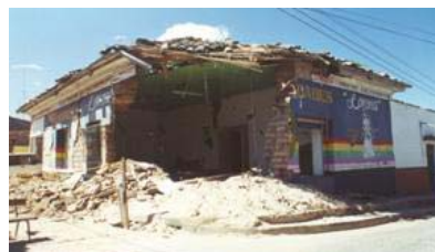
ترکهای عمودی در گوشه های دیوارها
