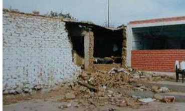
تخریب خانه های خشتی پرو مقابل زلزله
