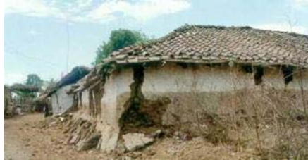
تخریب گوشه های دیوارها
