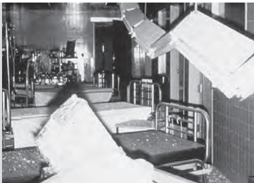
تخریب سقف کاذب و چراغ‌های سقفی بیمارستان در اثر زلزله
