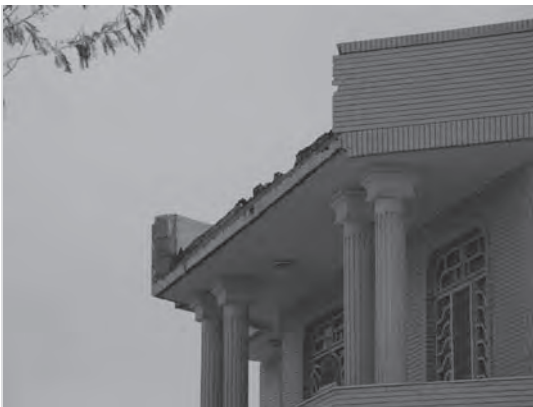
تخریب و سقوط دست‌انداز پشت‌بام در زلزله ۱۳۸۲ بم
