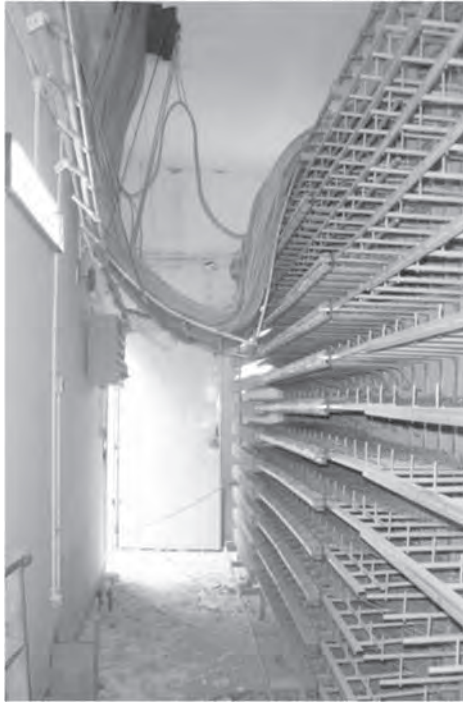
نمونه‌ای از خسارات وارد شده به کابل‌های الکتریکی در زلزله بم ۱۳۸۲
