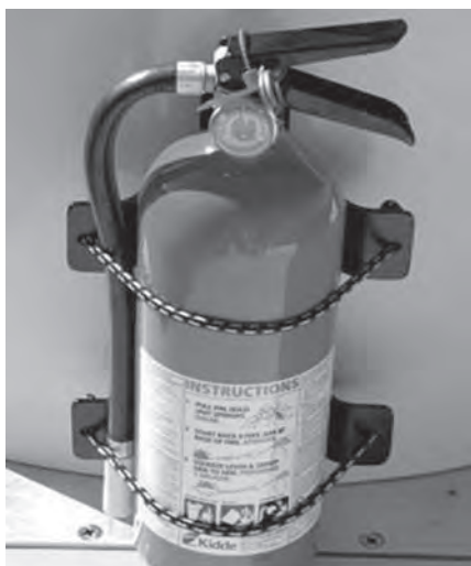
کپسول اطفای حریق مهار شده
