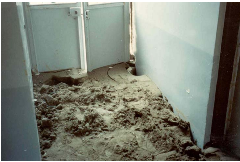
جوشش ماسه در کف خانه ای در آستانه اشرفیه
