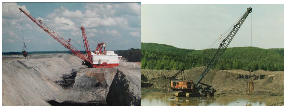
شکل شماره ۲-۱۲-۱- سمت چپ دراگلاین در حین حفاری گودال و سمت راست دراگلاین در حین حفاری زیر آب
