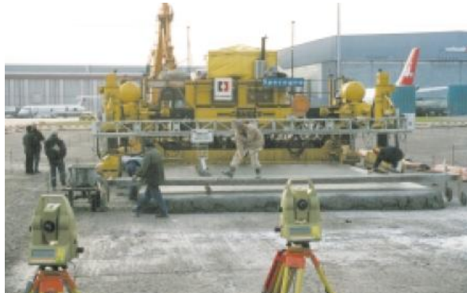
شکل ۲-۱۸-۹- استفاده از سیستم بدون سیم
