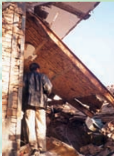
ضعف مقاطع ستون‌ها و اتصالات دو قسمت سازه منجر به تخریب آن شده است.
