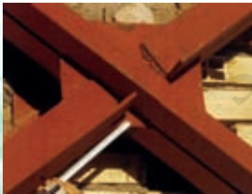
گسیختگی در اثر طول جوش کم عضو مهارب به ورق اتصال
