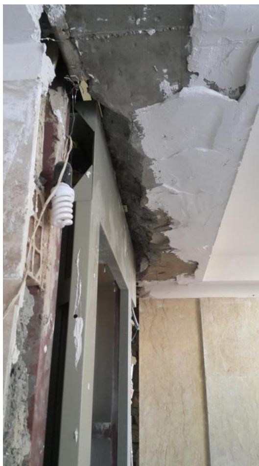
شکل ۱- تخریب پوتر برای نصب درب آسانسور به علت عدم دقت در جانمایی و کنترل ابعاد چاله آسانسور
