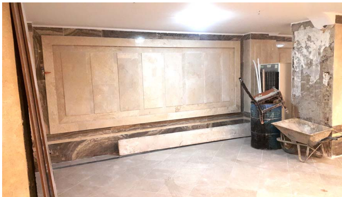
شکل ۳- عدم سنگکاری ستون برای تامین پارکینگ، به علت عدم دقت در جانمایی ستون ها.
