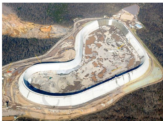
بزرگترین سد آمریکای شمالی که با بتن غلطکی ساخته شده است.
